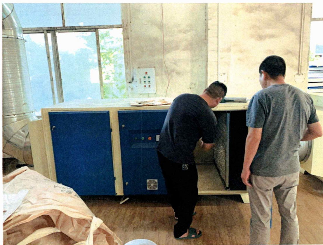
熔融挤出工序废气 UV 光解处理设备
