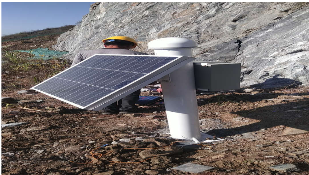
边坡在线监测装置
